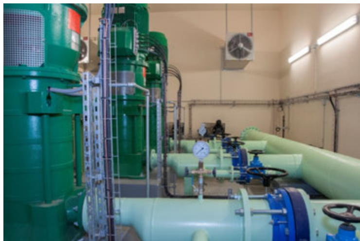
Les trois groupes de pompage à l'intérieur de la station.
